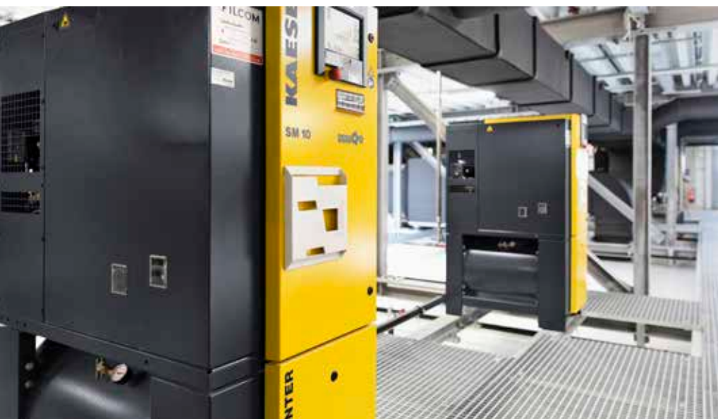
2台のAIRCENTERが新しいロジスティクスセンターに設置されています。
