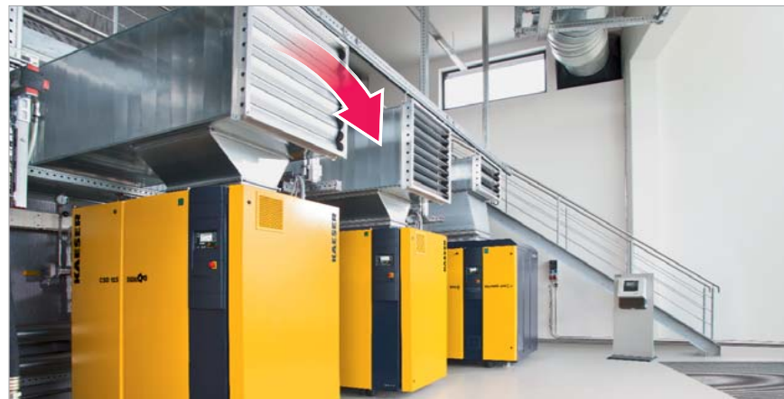
図3: サーモスタット制御のエアダクトを備えた圧縮空気ステーション
