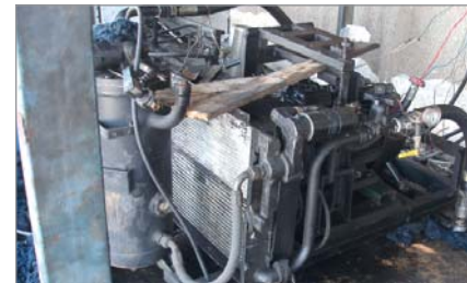
図1: メンテナンスを怠った圧縮空気ステーション
